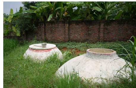
Die oberirdischen Teile der Biogasanlage. Foto: Nexus for Development
